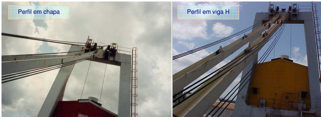
Tirantes originais e os que foram trocados em 1995.
